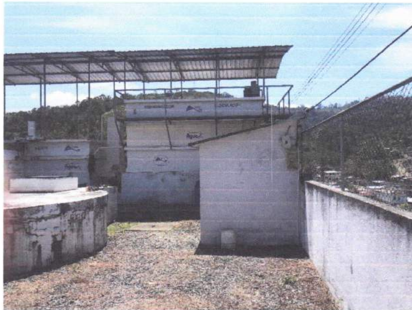
Planta de tratamiento de agua potable
