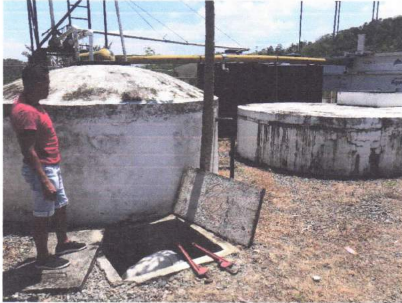
Planta de tratamiento de agua potable
